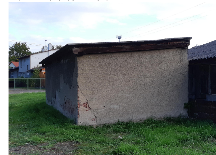
PŘÍSTAVBA DOPORUČENÁ K ODSTRANĚNÍ
